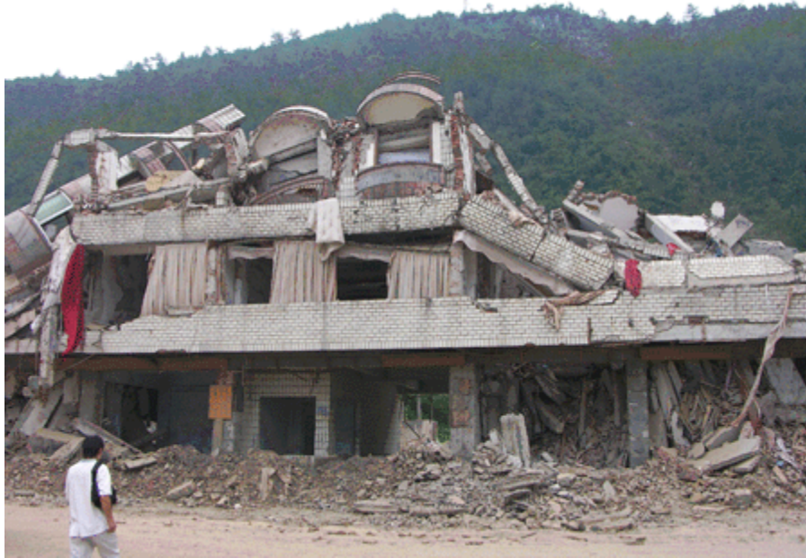
图五：混合结构类型建筑（上层是约束砌体，底层是钢筋混凝土）受损严重（此照摄于青川县）。
