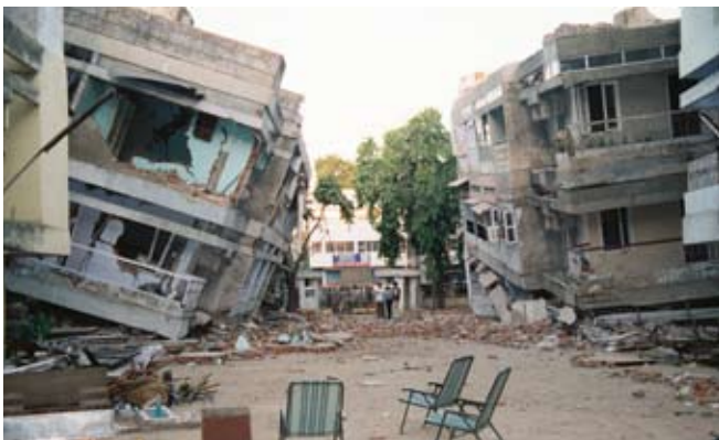
印度Bhuj地震中的建筑物“软层”倒塌 (来源: AIR)
